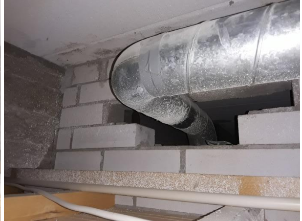
Kuva nro 9 avoin läpivienti wc-tilan alaslaskun päälle
