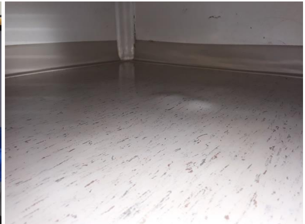
Kuva nro 6 pinnoite on osin irronnut alustaan
