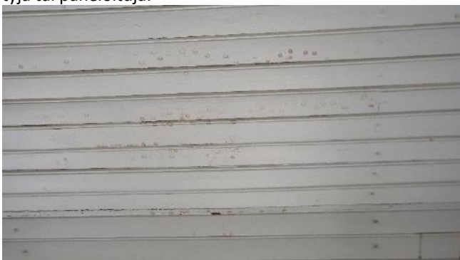
Kuva 11. Kattopaneeleissa oli useassa huoneessa jälkiä katon "pisaroinnin" jälkeen.
