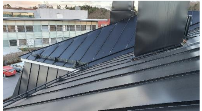
Kuva 57. Peltivesikate on uusi ja hyväkuntoinen.
