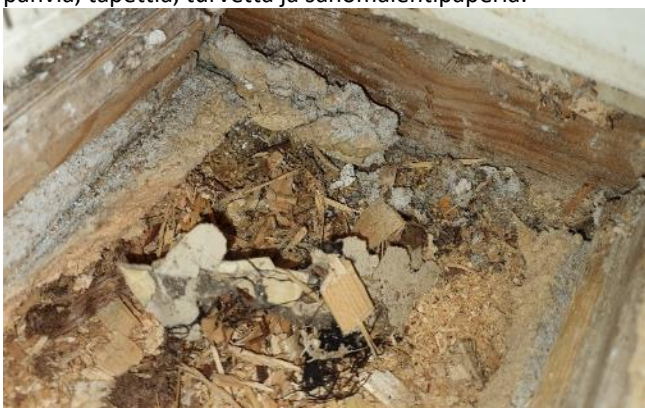
Kuva 30. Huoneen 106 ulkonurkassa ulkoseinän hirsien vieressä puru- ja turvetäytöt olivat mikrobivaurioituneet.
