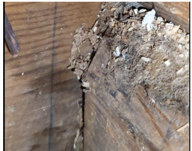
Kuva 41. Hirren sisäpinnassa havaittiin kosteuden aiheuttamaa tummentumaa, mutta puuaines oli kovaa. Hirsien välissä oleva pellavarive oli mikrobivaurioitunutta.
