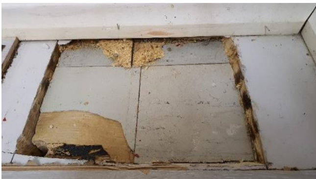
Kuva 26. Alapohjarakenteeseen on jätetty useita aiempia pintamateriaaleja, joista osa todennäköisesti sisältää asbestia (mm. kuvan musta liima).
