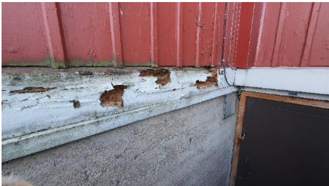
Kuva 36. Kellariin johtavan portaikon kohdalla seinän alaosassa kulkeva vaakalauta oli pahoin lahovaurioitunut.
