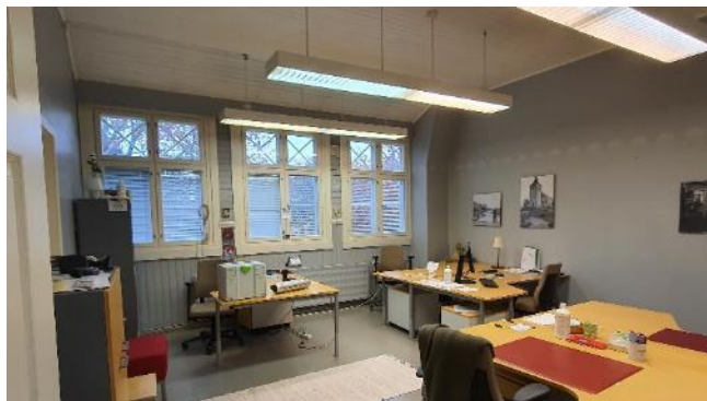
Kuva 43. Huoneen 210 ulkonurkka on koteloitu mansardikaton muodon vuoksi.
