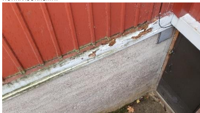
Kuva 6. Kellaritilan sisäänkäynnin luona sokkelin päällä olevissa puurakenteissa on lahovaurioita.
