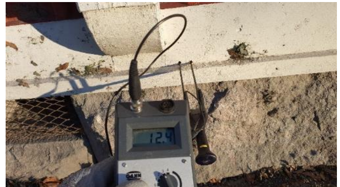
Kuva 35. Alimman hirsikerran kuntoa arvioitiin puun kosteusmittauksin sekä tätä varten laudoituksen läpi hirteen poratuin rei'in.
