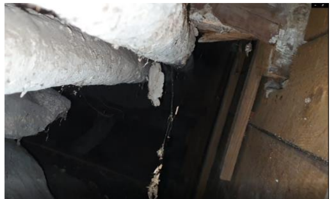
Kuva 20. Kellaritilan itäseinällä ryömintätilaan oli jätetty muotti-/tukilautoitusta.
