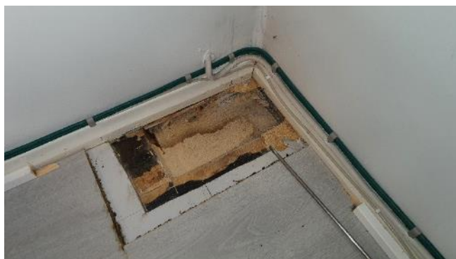
Kuva 29. Myös huoneen 106 ulkonurkassa puukuitulevy on kastunut jossain vaiheessa.
