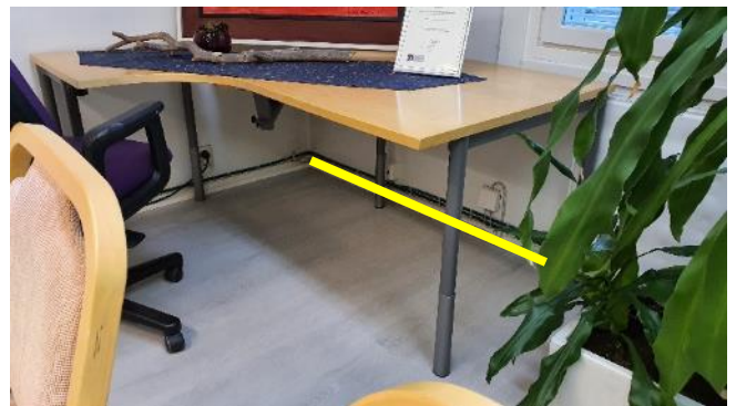
Kuva 24. Ulkoseinän ja alapohjan liitoksesta havaittiin vähäistä ilmavuotoa (keltainen) ryömintätilasta tilaan 106.
