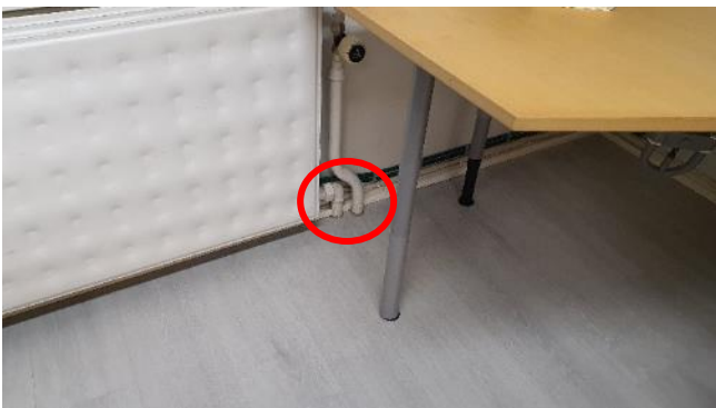
Kuva 23. Ryömintätilasta havaittiin merkittävää ilmavuotoa (punainen korostus) patteriputkien läpiviennin kautta.
