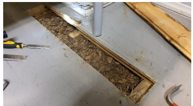
Kuva 52. Rakenneavaus R8 huoneen 214 jäähtyneelle alueelle.
