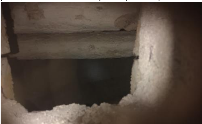
Kuva 19. Kellaritilan seinässä oli luokkuja ryömintätilaan, jossa kulkevien putkien eristeet sisältävät todennäköisesti asbestia.
