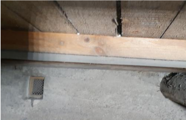
Kuva 21. Kellarin lännen puoleisella seinällä ei ryömintätilan puolella ollut laudoitusta. Kuvassa myös kellarin tuuletusluukku.
