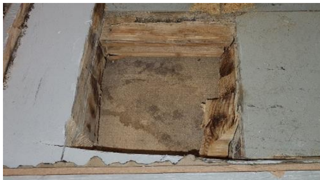
Kuva 27. Purutäytön yläpuolisessa puukuitulevyssä on kosteuden aiheuttamia jälkiä väliseinälinjan lähellä.
