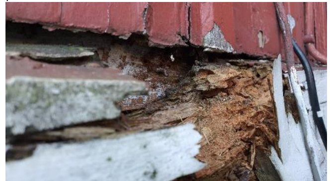
Kuva 37. Myös alin hirsi oli pehmeää ja kosteusmittauksen perusteella märkä.
