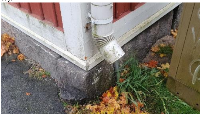
Kuva 5. Kattovedet ohjataan syöksyin rakennuksen seinustoille, jossa ne lisäävät sokkeli- ja seinärakenteiden kosteusrasitusta.
