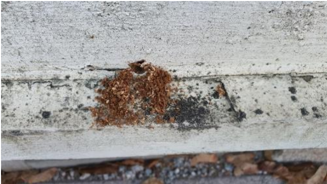
Kuva 38. Varaston 113 kohdalla ulkoseinän vaakalaudoitus oli lahovaurioitunut...
