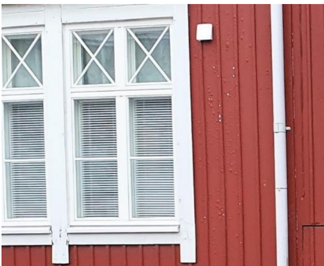
Kuva 7. Uudehkon näköisessä maalipinnassa on kupruilua etenkin rakennuksen koillisen puoleisella seinällä.
