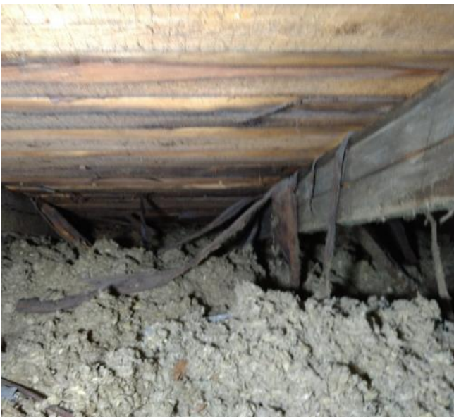
Kuva 53. Yläpohjaa on lisälämmöneristetty puhallusvillalla, joka osin tukkii räystästuuletuksen ullakotilaan.
