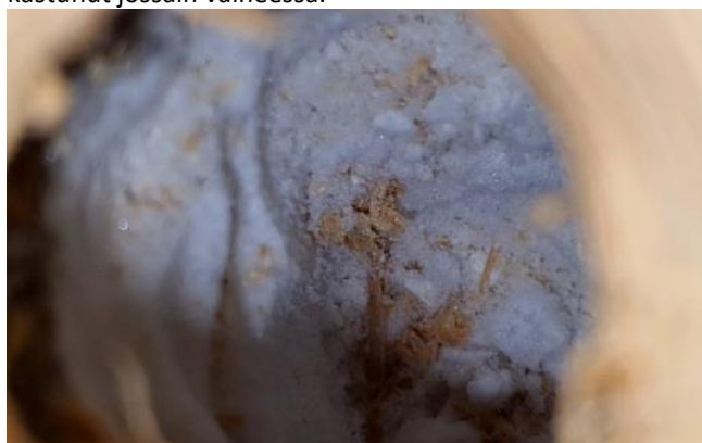
Kuva 31. Alapohjaan oli mahdollisesti eristekerroksen painumisen vuoksi lisätty myös ns. ureavaahtoa.
