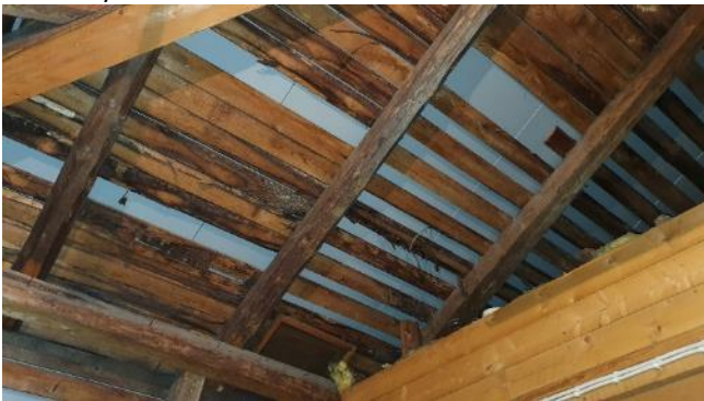
Kuva 15. Vesikatteena oli aluskatteeton pelti.
