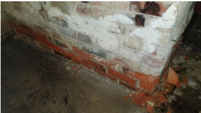
Kuva 17. Huoneen 106 alapuolisen kellarin lattialla oli vettä ja tilan seinärakenteet olivat paikoin pahoin rapautuneet.
