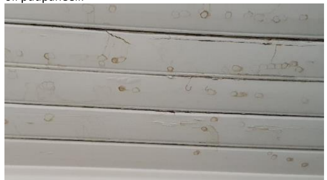
Kuva 12. Jälkien perusteella kyseessä voi olla sisäilman kosteuden tiivistyminen kattopinnalle yläpohjan riittämättömän lämmöneristyksen vuoksi.
