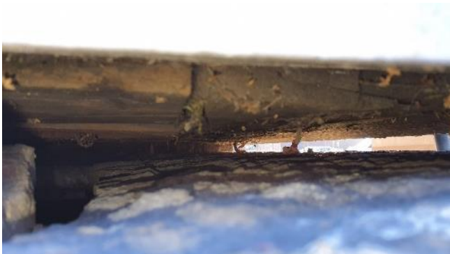
Kuva 34. Rakennuksen luoteisnurkassa alin hirsi oli irti luonnonkivisokkelista.
