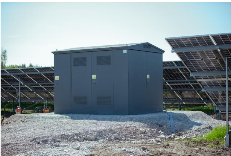
Kuva 6. Esimerkki muuntamosta, joka sijoitetaan aurinkopuistoon. Lähde: Helios Nordic Energy AB:n aurinkopuisto Kungsåra.
