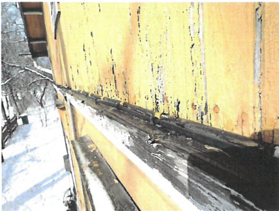
päädysssä vesi valuu jakopuun kohdalta rakenteisiin
