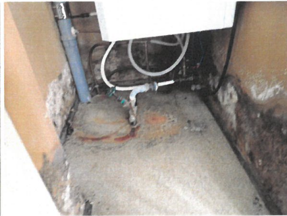
vesivaraajan alla seinien alareunoissa kosteuden aih. vaurioita, kuivat tarkastushetkellä
