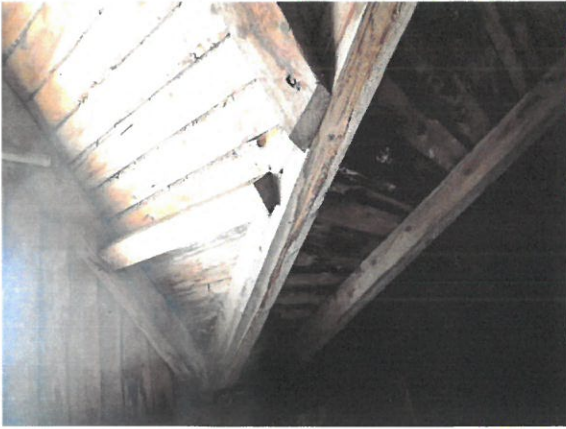
yläpohjassa jiirin pohja kostea, alla vesiastioita
