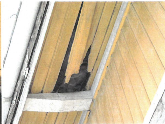
räystään alla vaurio
