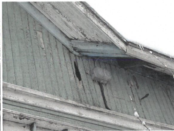
Siltavoudinkadun puolella räystäään alla vaurioita
