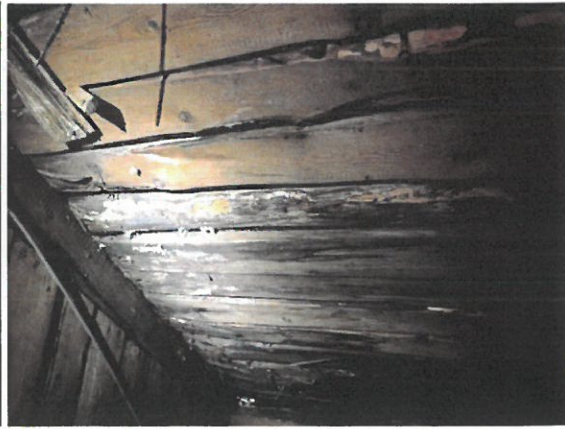
yläkertaan menevien portaiden päällä lahovaurioita
