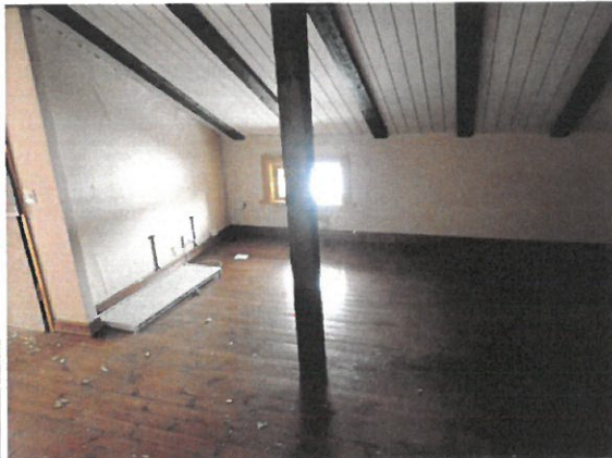
Sähköpattereita oli paikoin irroitettu seinästä, lattialla
