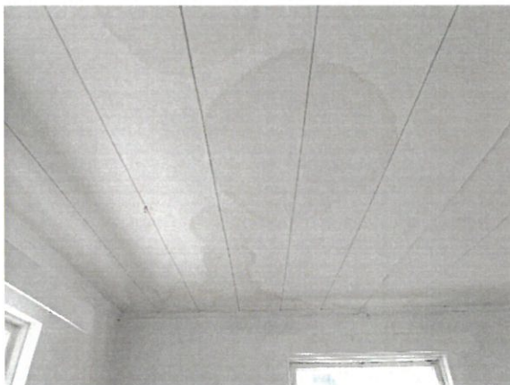
huoneen katossa kosteuden aih. tummentumia ja kattolevyt tarkastushetkellä osin märkiä
