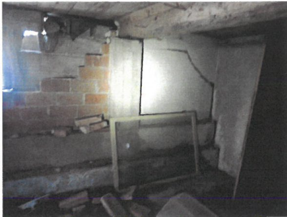
kellarissa halkeamaa + tiilimuuraus osin sortunut
