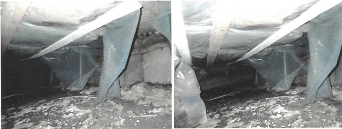
alapohjassa muovi, rakenteet ja maapohja kosteita
