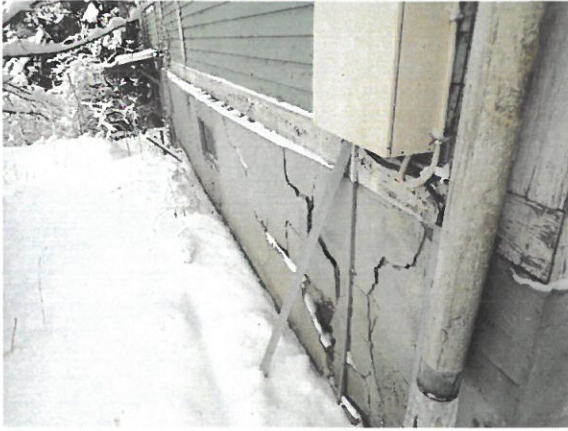
halkeamia / siirtymiä sokkelissa
