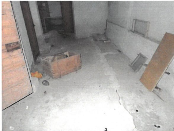
kellarin lattiassa halkeamia / painumaa
