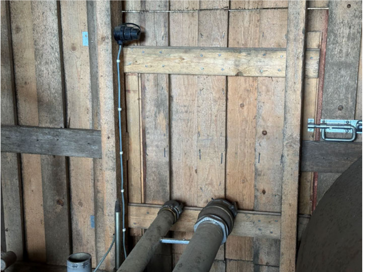
Kuva9: Rakennuksen takaseinän luukku, jonka kautta toimitetaan polttoaineet säiliöihin. Ylitäytön estin ja lukittavuus sisältä päin.
