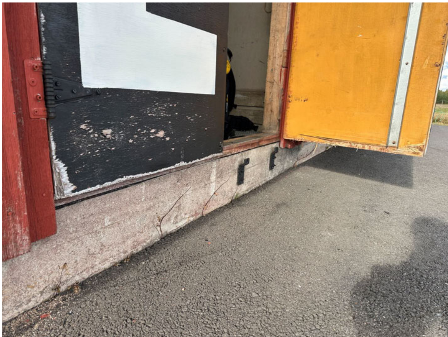
Kuva8: Suoja-altaan pohja on alempana kuin alueen asfaltointi
