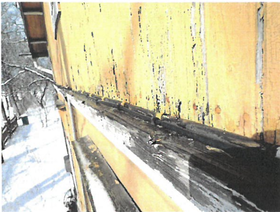
päädyssä vesi valuu jakopuun kohdalta rakenteisiin
