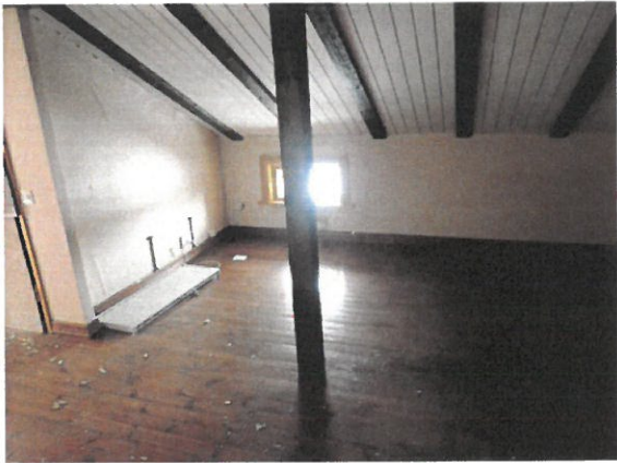
Sähköpattereita oli paikoin irroitettu seinästä, lattialla
