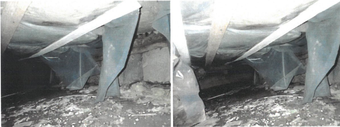
alapohjassa muovi, rakenteet ja maapohja kosteita
