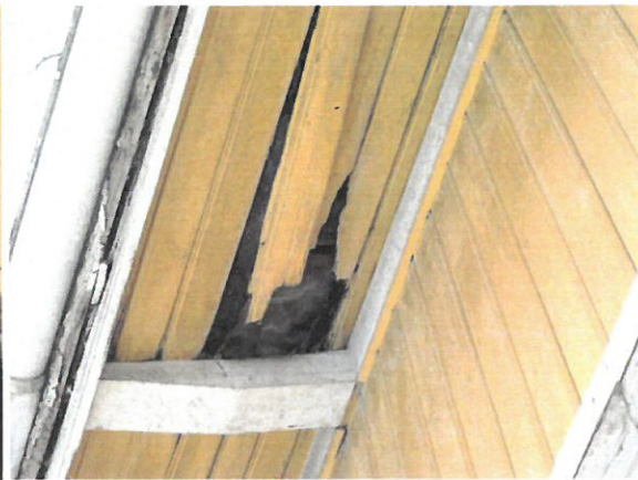
räystään alla vaurio
