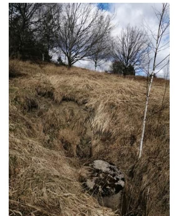
Kuva 27: Savinen maaperä on hienojakoista ja eroosioherkkää, mikä näkyy maastossa erityisesti rinteissä vanhojen hulevesikaivojen ympärillä, joista maa-aines on huuhtoutunut pois.
