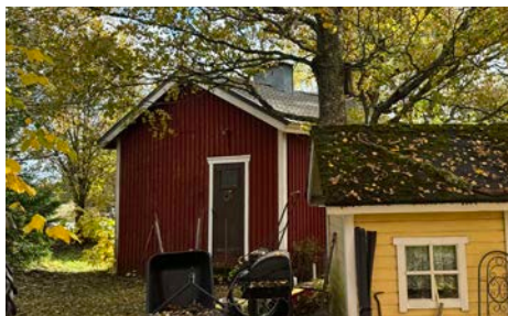
Vuonna 1993 tehdyn rakennusinventoinnin mukaan B-rakennus oli huonokuntoinen ja se oli tarkoitus purkaa. Vanha vaja oli perustettu nurkkakivien päälle.
