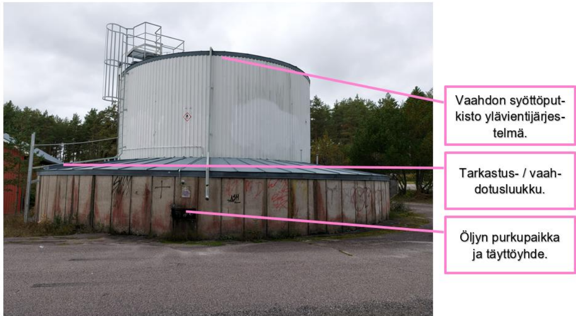
Kuva 9-1. Öljysäiliö ja öljynpurkupaikka edessä. Vaahdon syöttöputkisto nähtävissä edessä.
