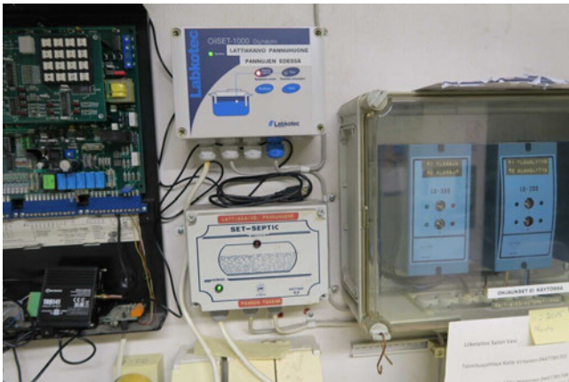
Kattilahuoneen lattiakaivo hälytin. Päiväljysäiliö. Myös muut tilat vastaava valvonta. Kaikki testattu
