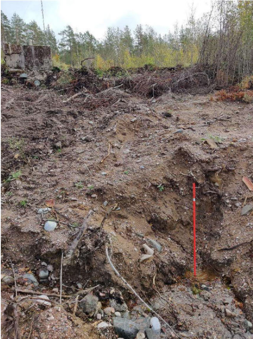
Kuva 2. [REDACTED] lähteen edestä oli poistettu pensaikko ja muu kasvillisuus. Huomioikepin kohdalta purkautuu vettä (9.10.2023). Kuva © [REDACTED]
