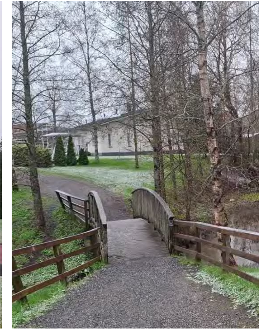
Kuva 15. Pesälammien huonokuntoinen silta
